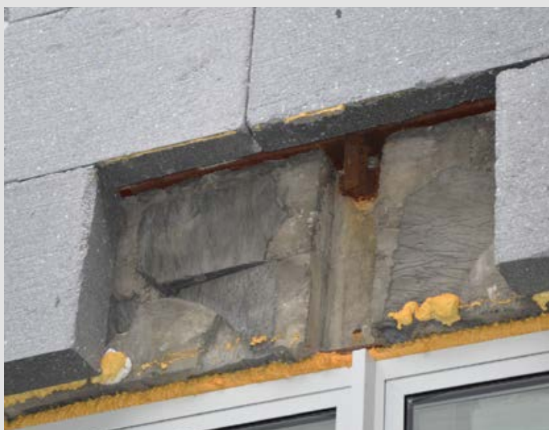
Фото 5. Неправильна підготовка основи.
