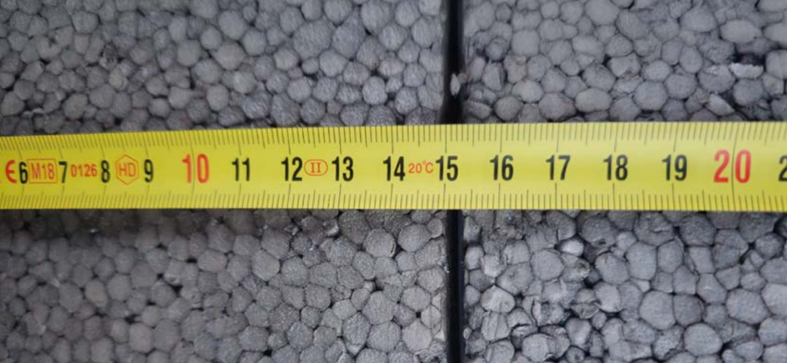
Фото 6. Незаповнені щілини в швах теплоізоляції з плит пінополістиролу (приклад помилки виконання).
