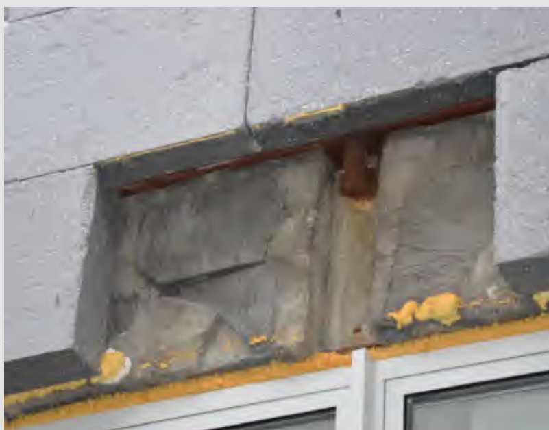
Фото 5. Неправильна підготовка основи.
